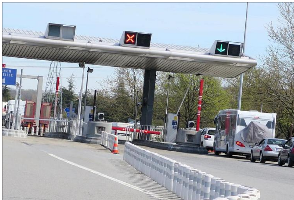
Les sociétés d'autoroutes ont investi dans des moyens de surveillance performants (vidéo et alarme) pour lutter contre la fraude. Le DL
